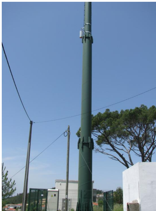
Pormenor da Antena do 'gap-filler' de Vila de Rei
